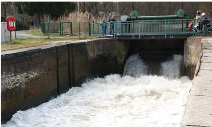
Ablaus aus der zum Wehr umgebauten südlichen Schleusenkammer vom Altkanal zum Plauer See
